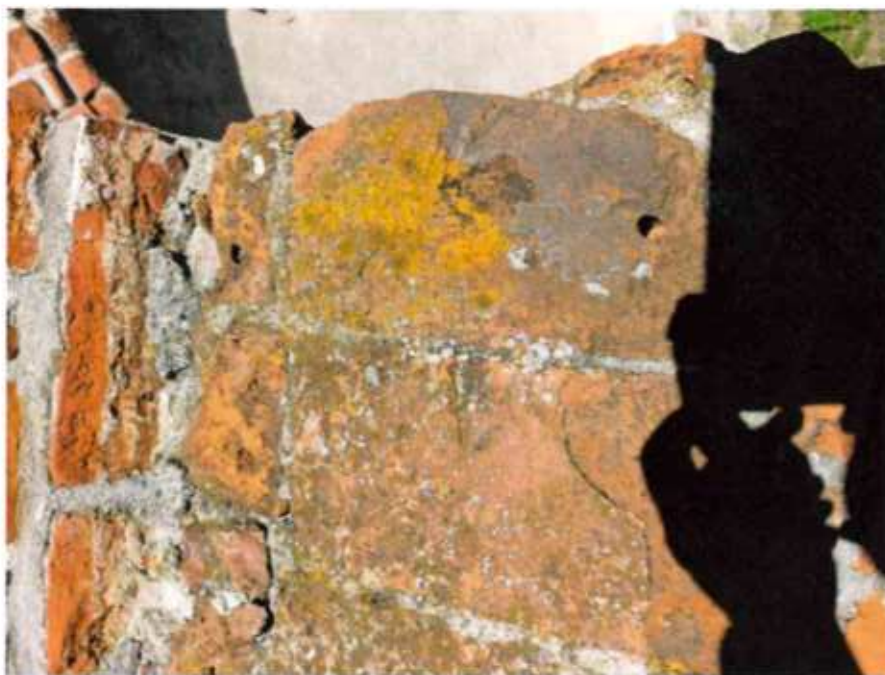
Ilustracja 17: Erozja okapów szkarp, glony, porosty, spoiny cementowe
