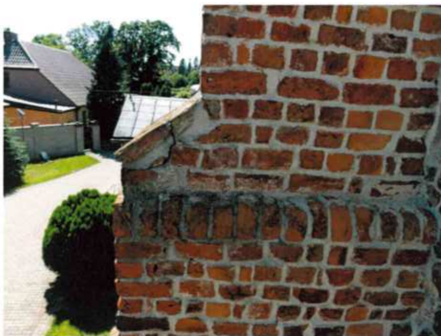
Ilustracja 29: Destabilizacja okapów szkarp, degradacja spoin cementowych, zacierki z wypraw
