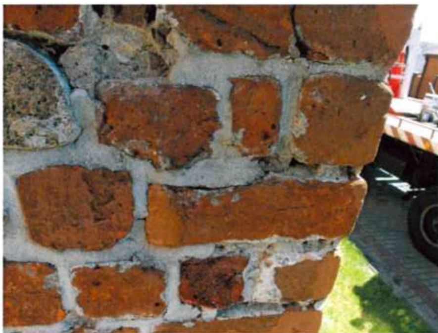
Ilustracja 13: Destabilizacja wstępu ceglanego wskutek erozji spoin
