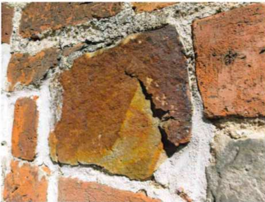
Ilustracja 8: Erozja wątku kamiennego, piaskowiec
