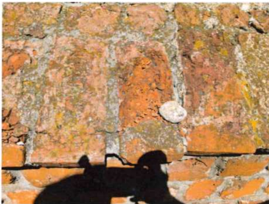
Ilustracja 16: Erozja okapów szkarp, glony, porosty, spoiny cementowe
