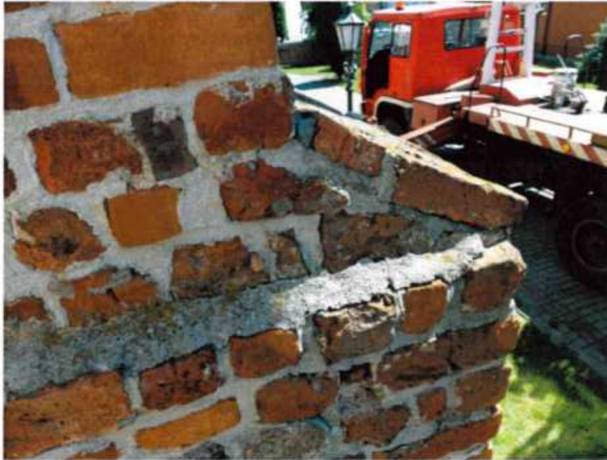
Ilustracja 11: Destabilizacja szkarp na skutek degradacji spoin cementowych o różnej nasiąkliwości
