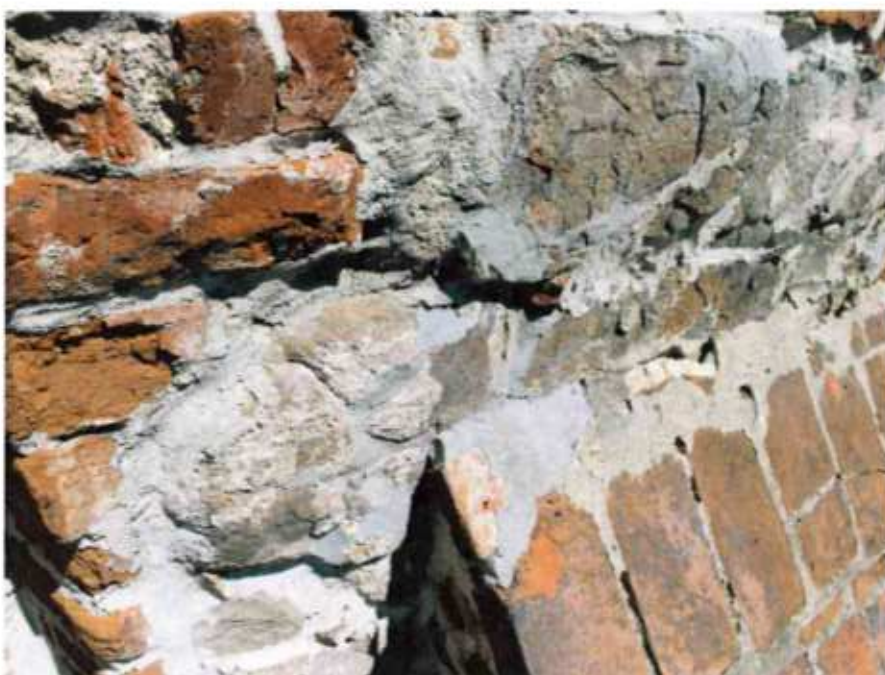
Ilustracja 10: Erozja okapów szkarp, przecierki cementowe na spoinach
