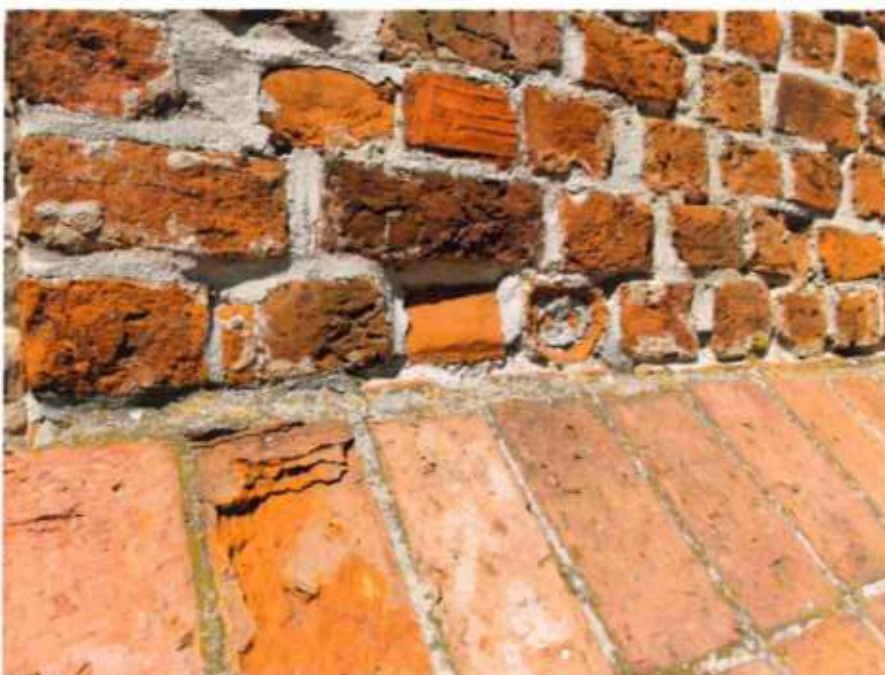
Ilustracja 28: Erozja szkarp, przemieszanie różnej gatunkowo spoiny
