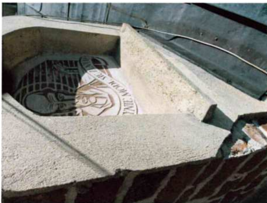
Ilustracja 2: Odspojenia wypraw tynkarskich na obramieniach blend szkarpowych
