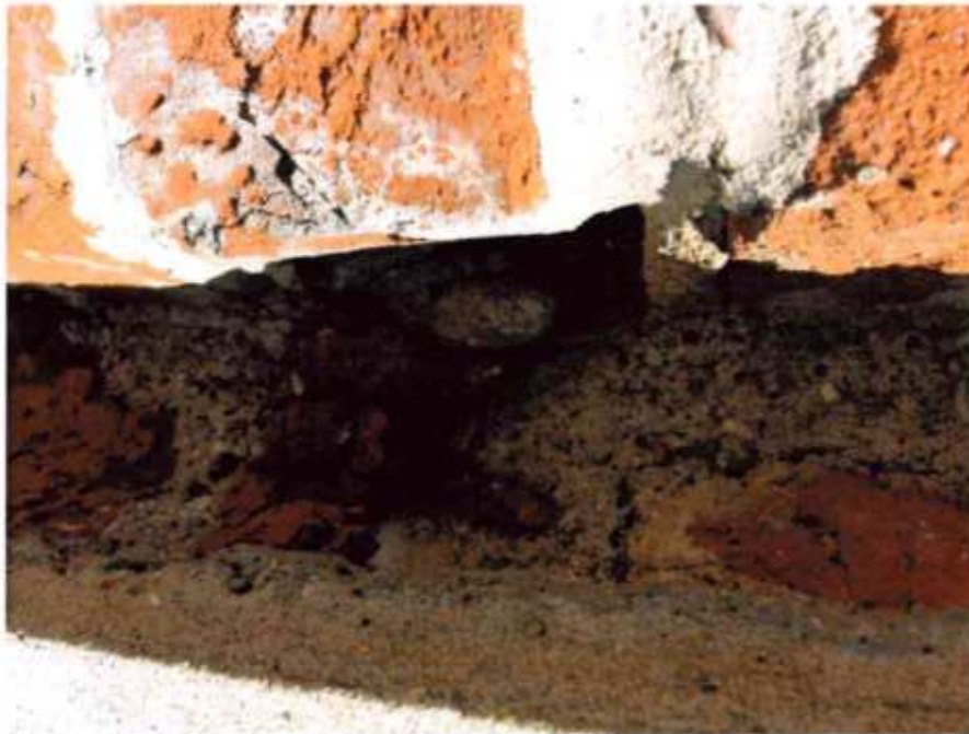
Ilustracja 7: Erozja wątku ceglanego i spoin
