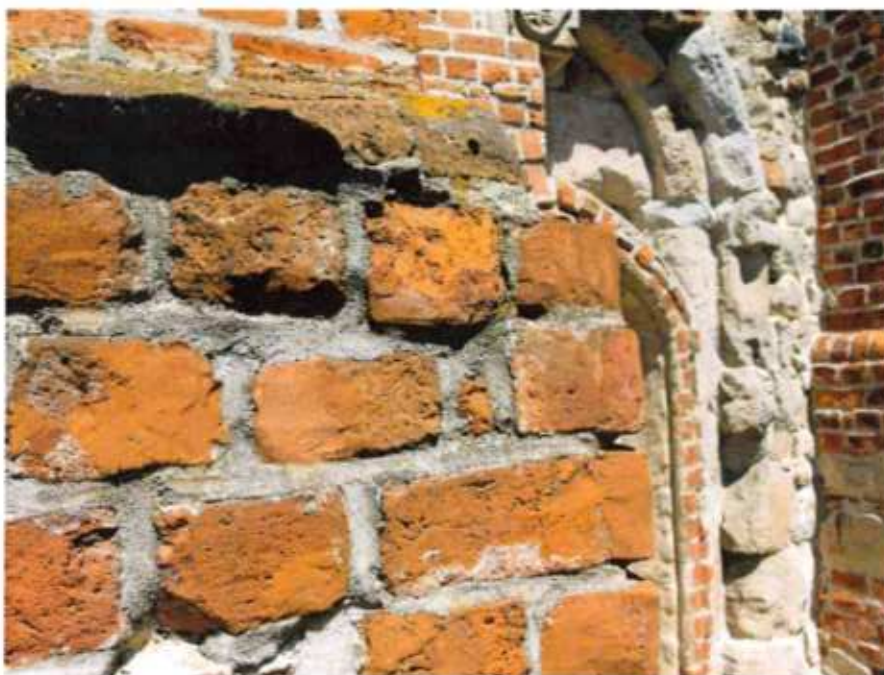
Ilustracja 18: Erozja biologiczna, spoiny cementowe na średniowiecznym wątku ceglany
