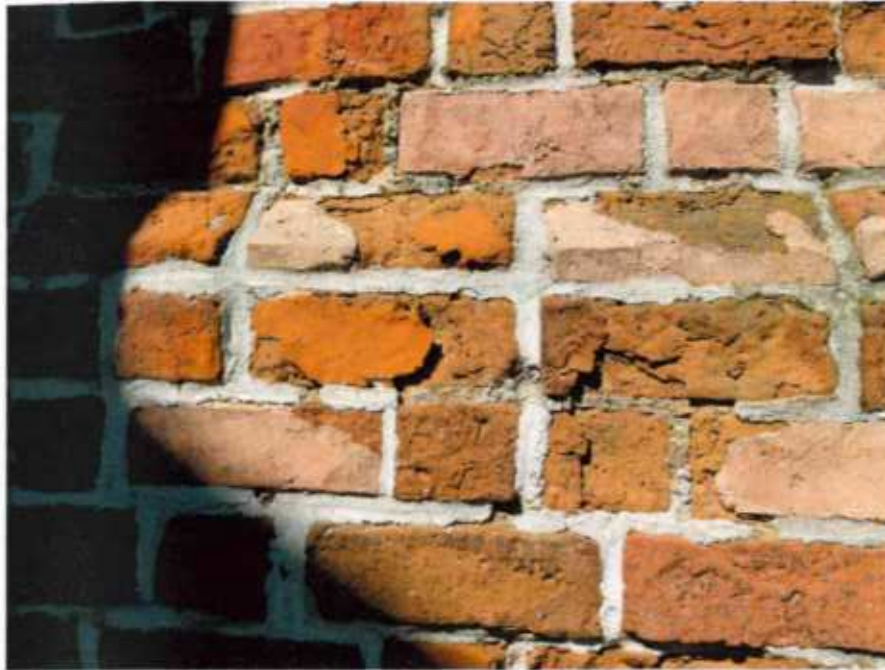
Ilustracja 33: Erozja wstęgu ceglanego, atak biologiczny, wyprawy masą Atlas, spoiny cementowe
