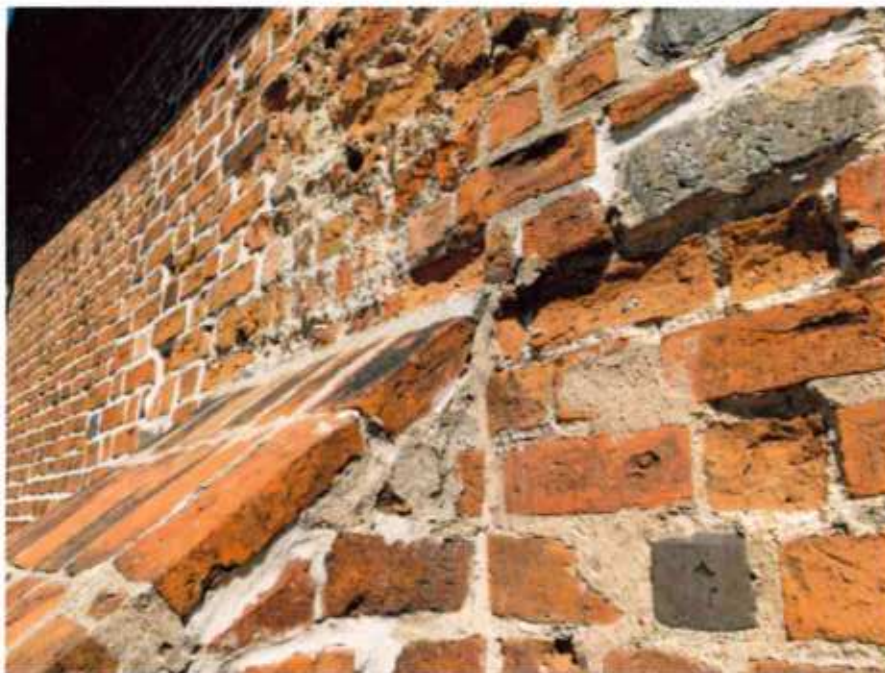
Ilustracja 5: Erozja wątku ceglanego, przecierki cementowe na spoinie i wątku ceglanym
