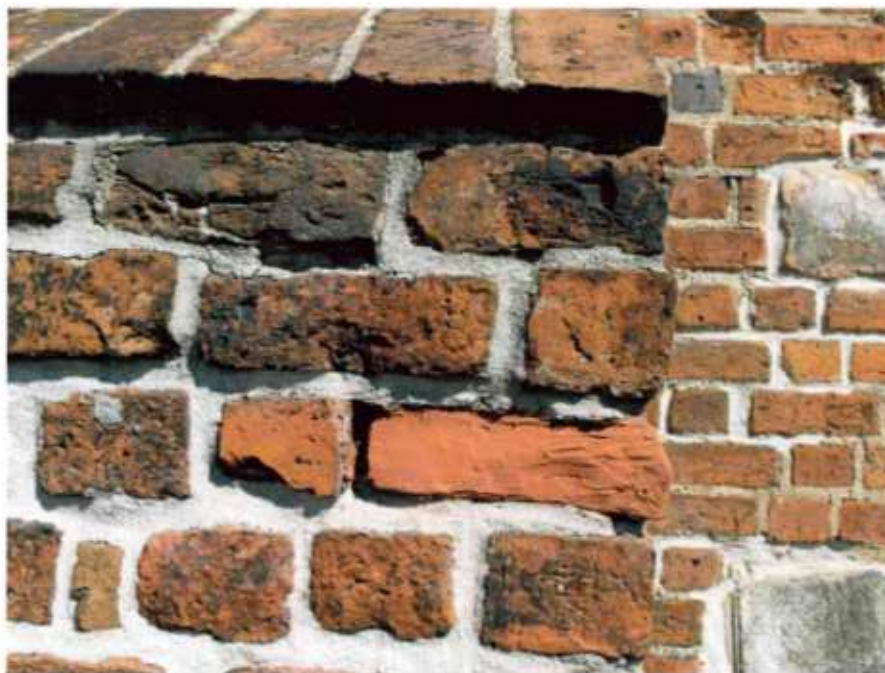
Ilustracja 3: Wyprawy konserwatorskie na ceglach, przecierki zaprawą cementową
