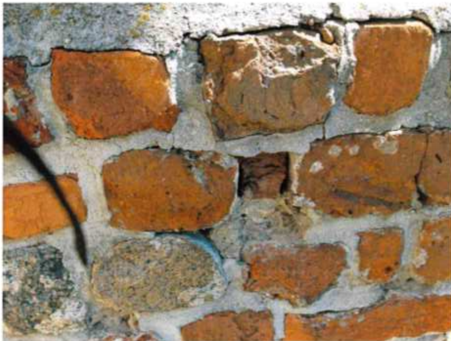
Ilustracja 12: Destabilizacja wstępu ceglanego wskutek erozji spoin
