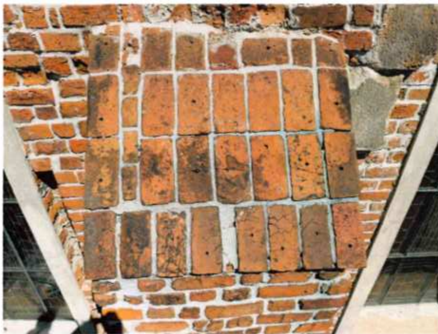
Ilustracja 9: Degradacja okapów szkarp, odkryte otwory montażowe
