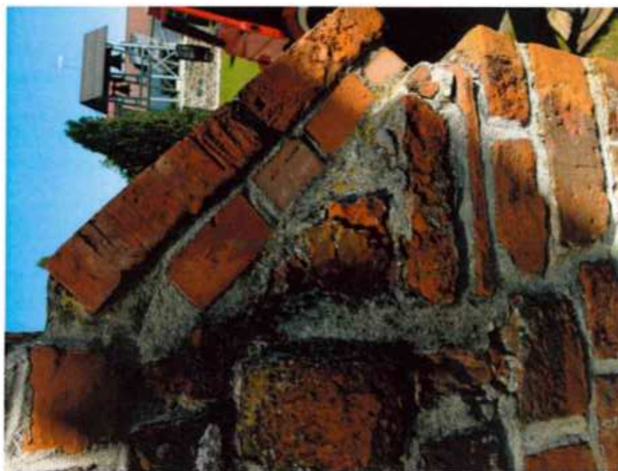
Ilustracja 21: Erozja wstęgu ceglanego na szkarpach, destrukcja biologiczna, spoina cementowa
