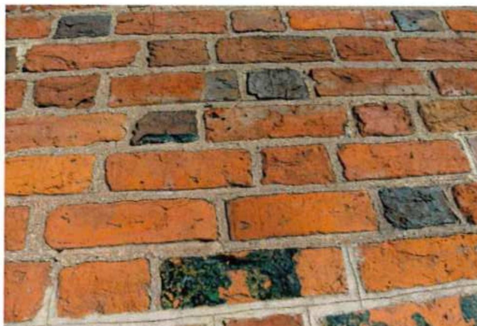
Analogia wykonawcza - watek ceramiczny gotycki, fragmenty oryginalnej spoiny, kościół p.w. N.M.P. w Poznaniu.
