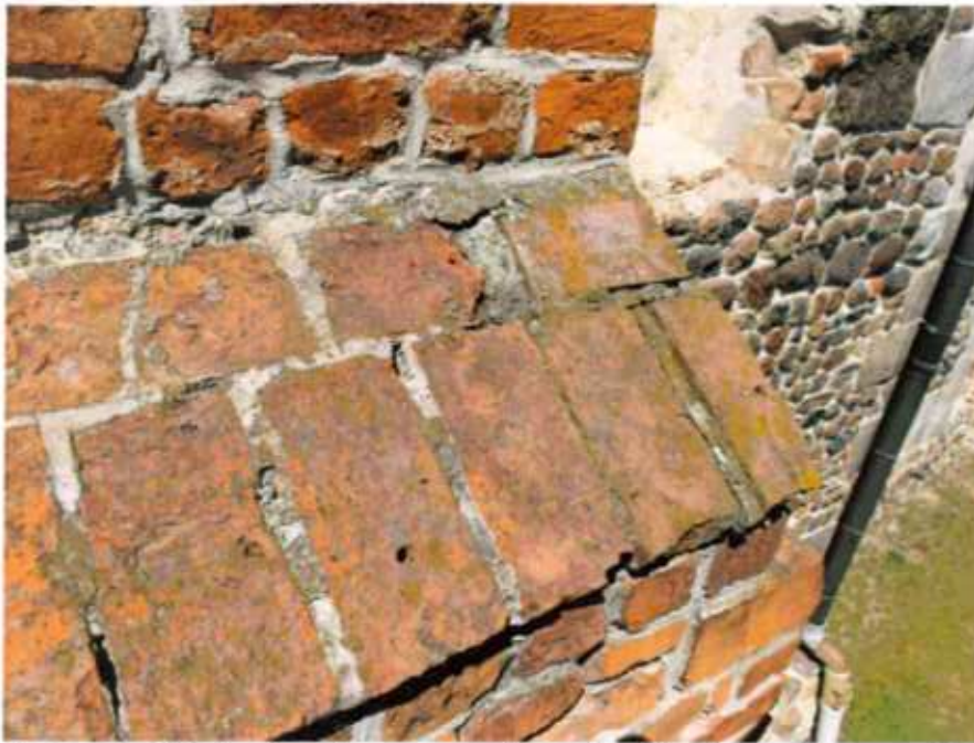
Ilustracja 25: Erozja szkarp, przemieszanie różnej gatunkowo spoiny
