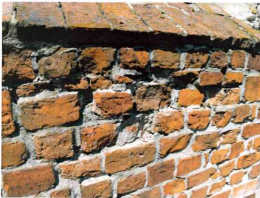
Ilustracja 26: Erozja szkarp, przemieszanie różnej gatunkowo spoiny
