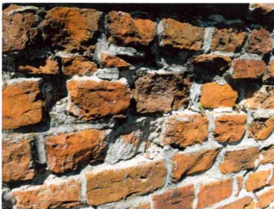
Ilustracja 27: Erozja szkarp, przemieszanie różnej gatunkowo spoiny
