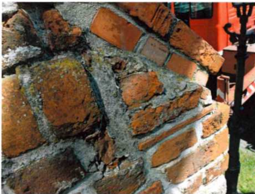
Ilustracja 23: Erozja biologiczna, spoiny cementowe, współczesne cegły
