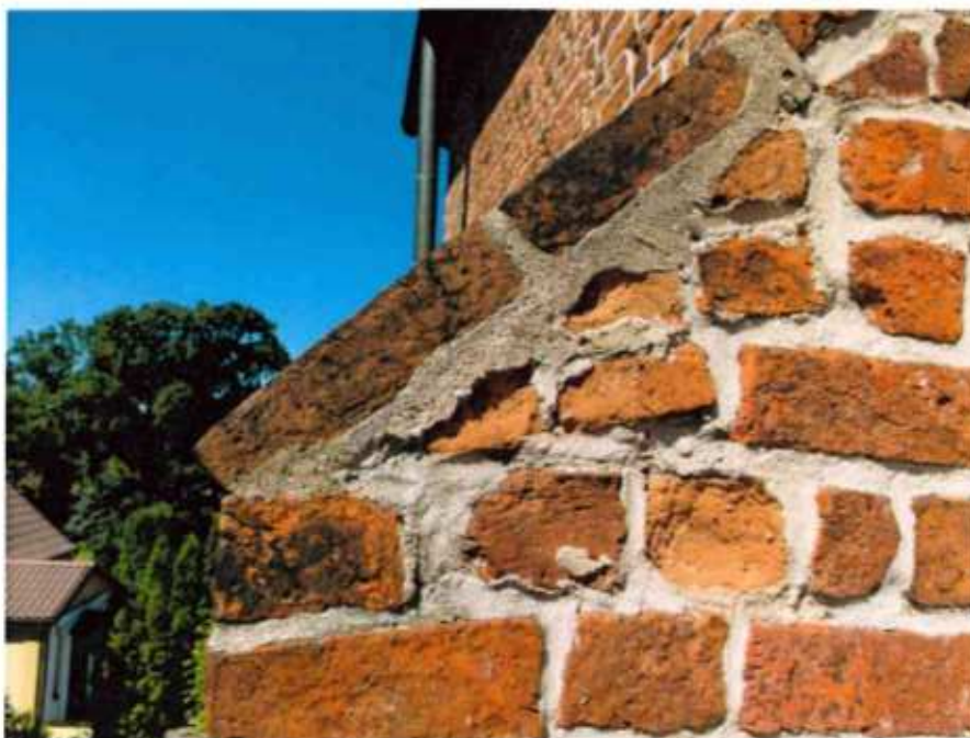
Ilustracja 6: Erozja wątku ceglanego, przecierki cementowe na spoinie i wątku ceglanym
