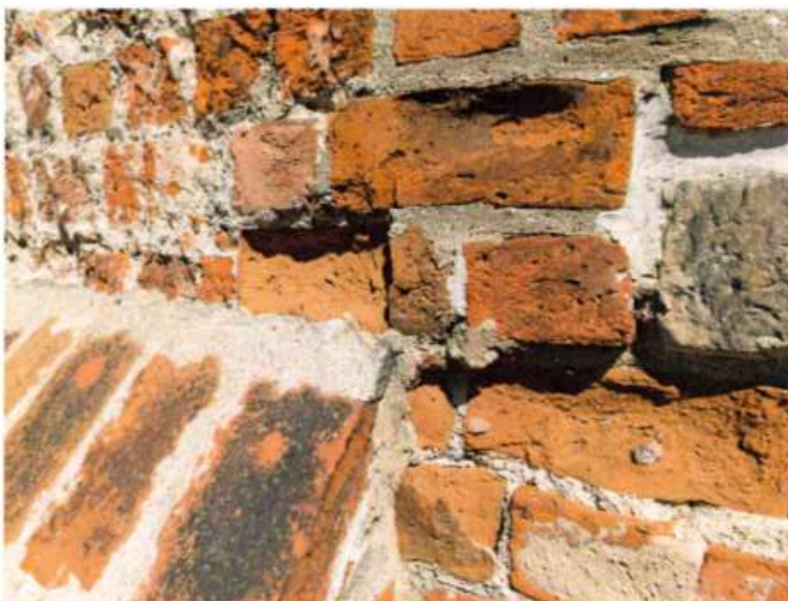
Ilustracja 4: Erozja wstęgu ceglanego, przecierki cementowe na spoinie i wstęgu ceglanym
