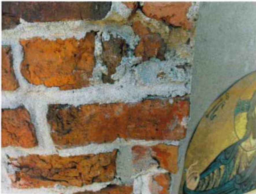
Ilustracja 34: Erozja cegieł i spoiny o różnej zawartości cementu
